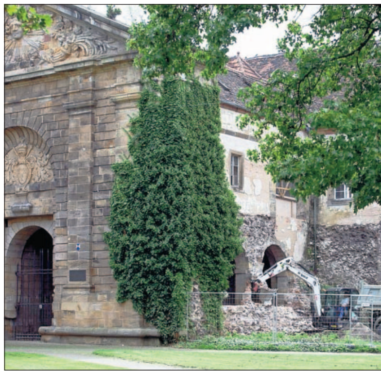
Erschrocken zeigte sich eine Besucherin aus dem Schwarzwald über den Zustand des Deutschen Tors. Mittlerweile haben die Sanierungsarbeiten jedoch begonnen.
